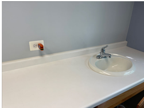
Non GFCI Outlet 206
