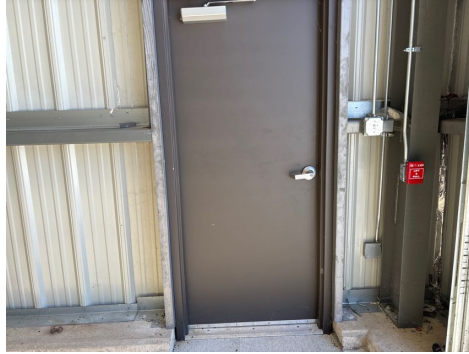
Dock Door Stuck
