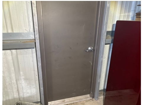
Dock Door Stuck
